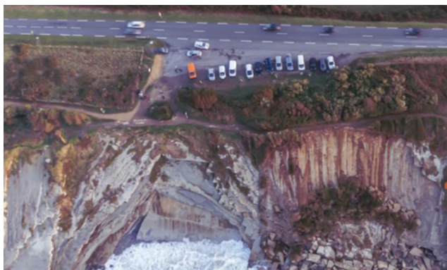
Effondrement d'un bout de falaise sur la Corniche - 2020
