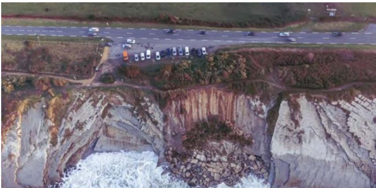
Figure 3. Effondrement d'une falaise à Urrugne (Source : Sud-Ouest, credit photo Yannis Comte)
